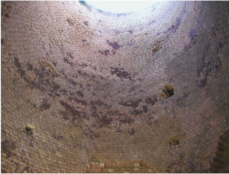
Fig. 4.108. Forro refractario del horno
