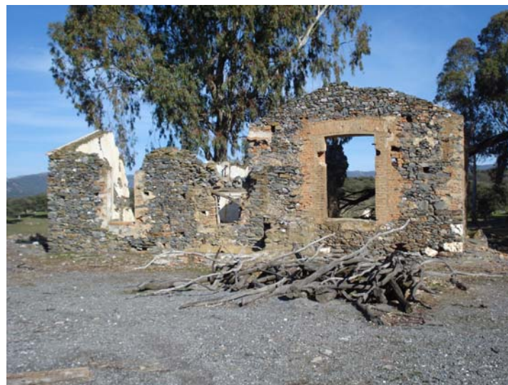
Fig. 4.180. Casa de máquinas pozo I
